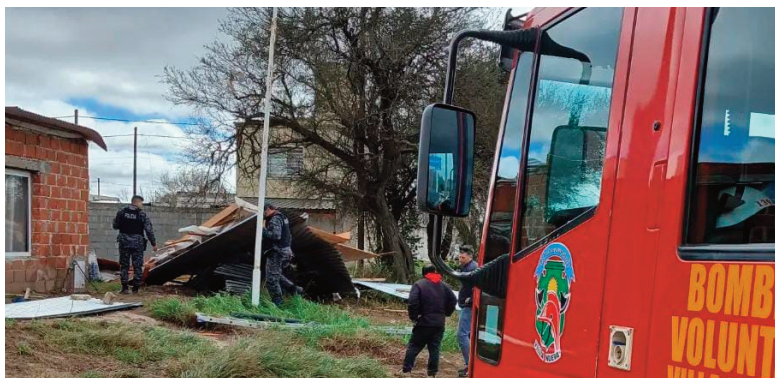
Bomberos y policías trabajaron en Villa Nueva tras la voladura de un techo.
