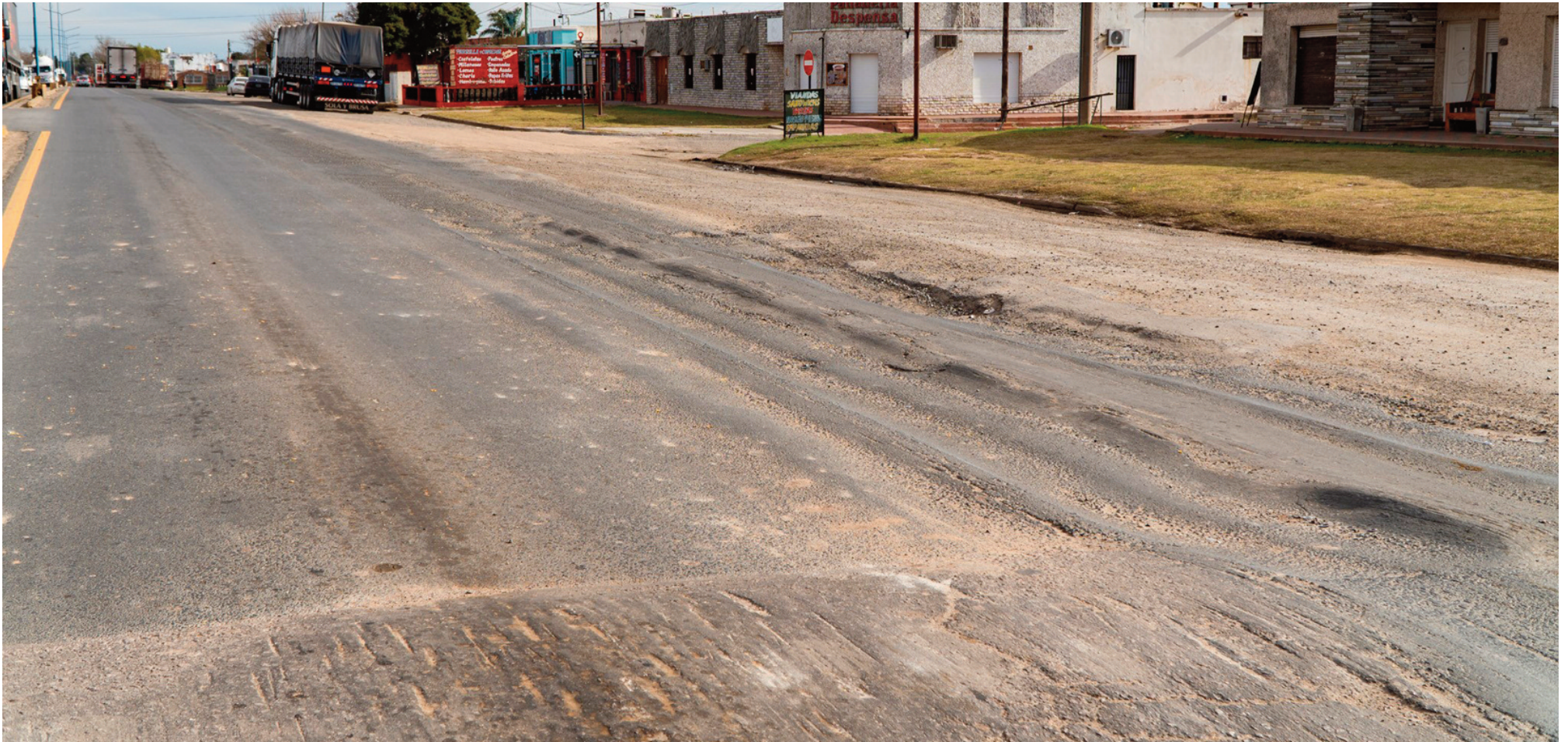
Así es el deterioro de la ruta 8 que pasa por Holmberg.
