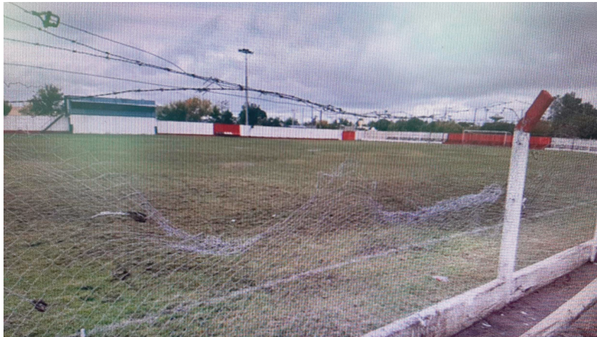
El alambrado muy dañado en la cancha de Colón, es una prueba elocuente de los hechos de violencia tras el clásico, que aportó la Policía buscando prevención.
