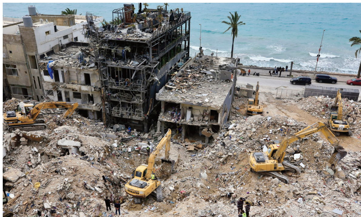
Retroexcavadoras remueven escombros en la ciudad libanesa de Tiro, tras un bombardeo israelí.
