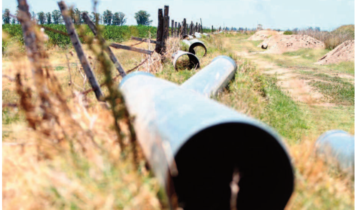
En noviembre de 2022 los caños iban colocándose al costado de los alambrados para luego realizar la excavación para el acueducto.
