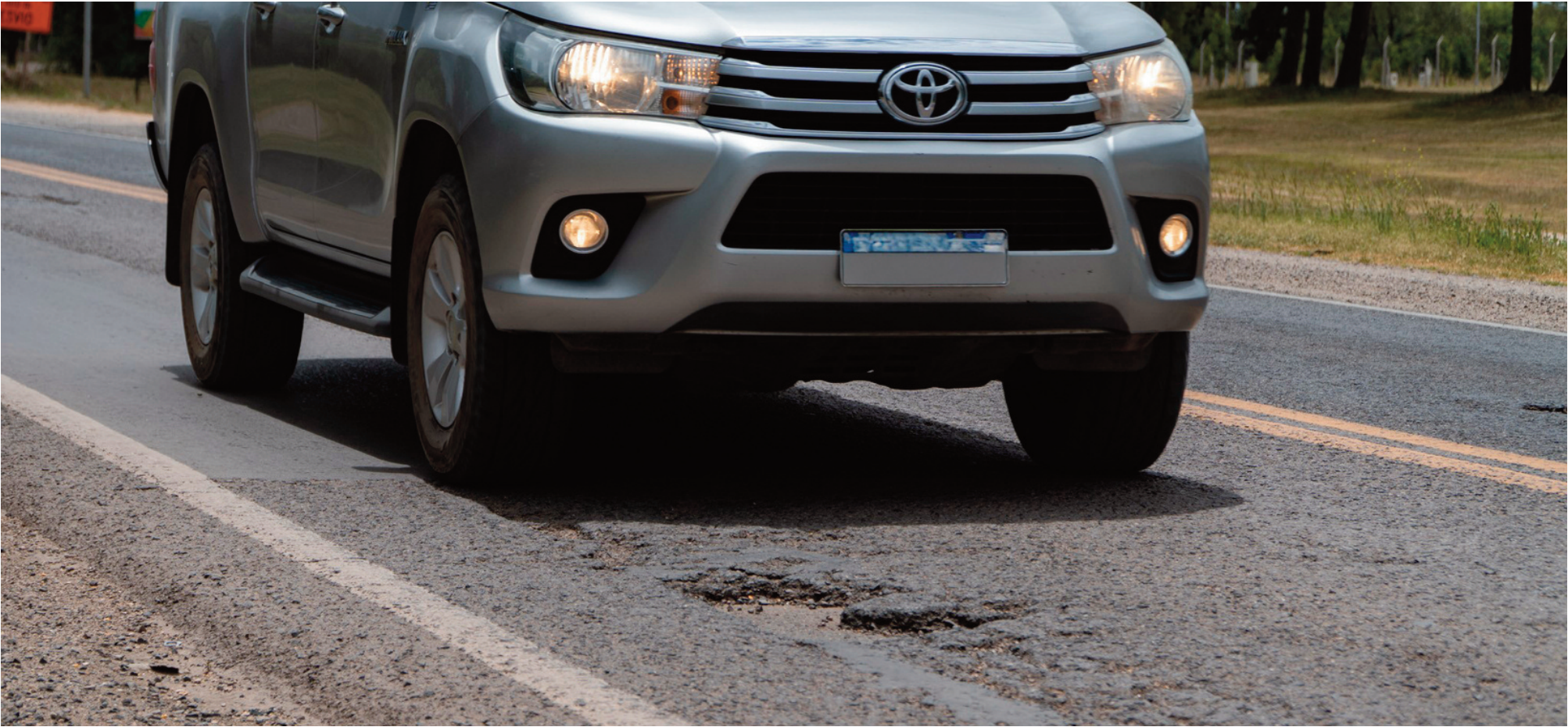
Se profundiza el deterioro de las rutas.
