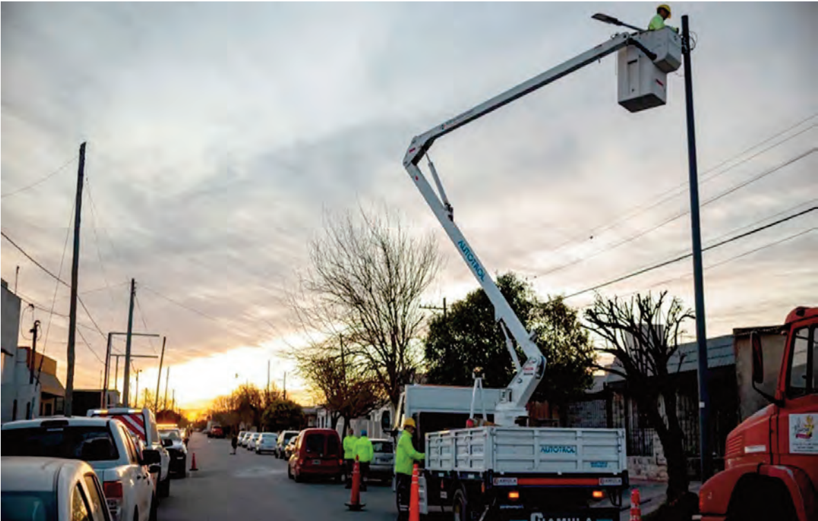
Actualmente, la prestataria del servicio es la empresa Autotrol.
