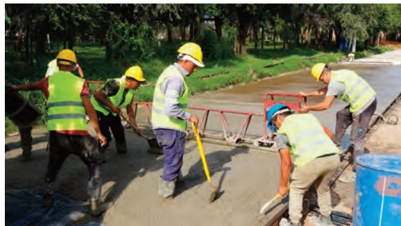
Operarios del Municipio llevan a cabo las tareas de hormigonado en el sector este de la ciudad. Allí se pavimentarán más de 750 metros de avenida y se construirá un cantero central.
