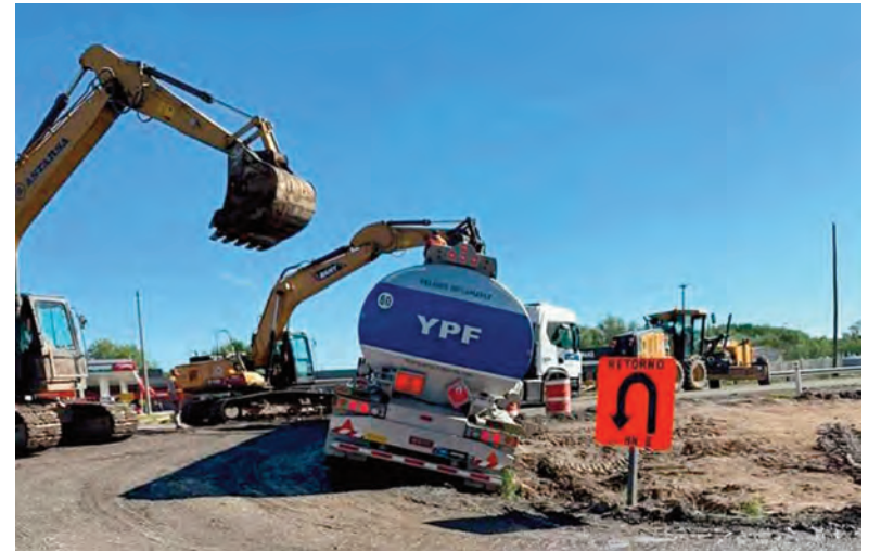
El camión pudo ser retirado sin que se registraran daños materiales.
