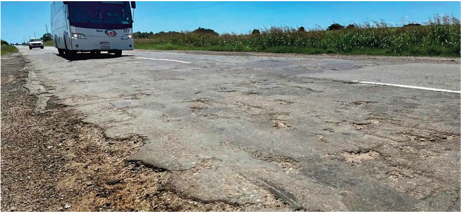
Reclaman por el deterioro de la ruta 158.
