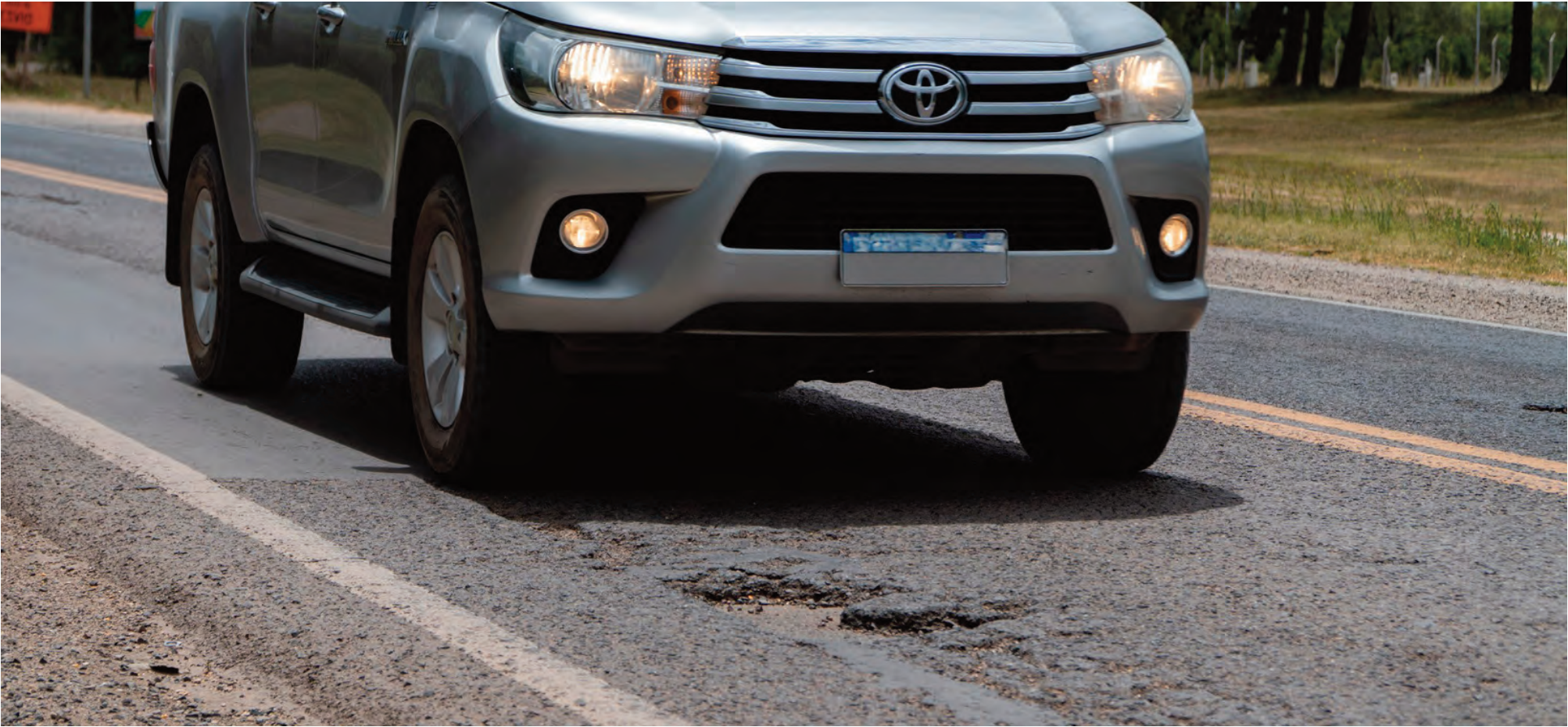
Se profundiza el deterioro de las rutas.
