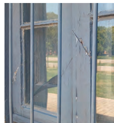
Una ventana lateral del edificio, con daños.
