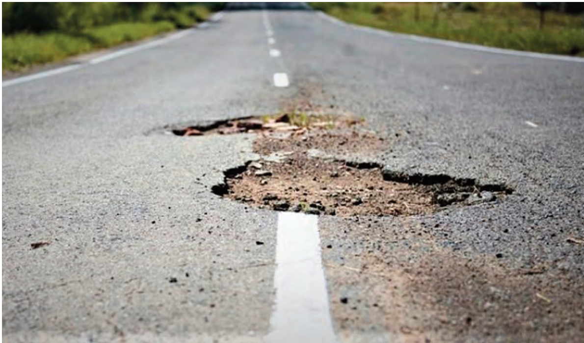
El notorio deterioro de muchas rutas es causa de accidentes.
