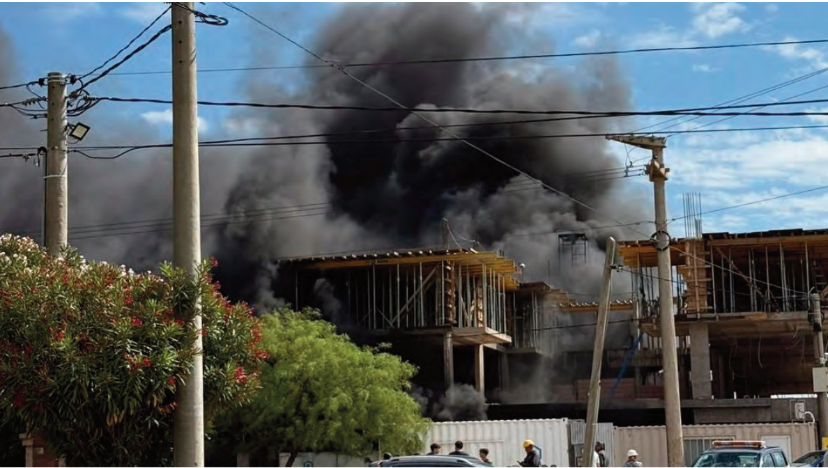
La inmensa columna de humo que provenía desde el edificio en construcción pudo verse desde diferentes barrios de la ciudad.
