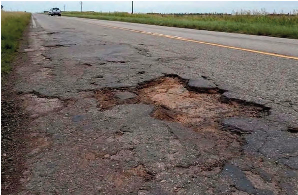
La ruta 158 está en malas condiciones.
