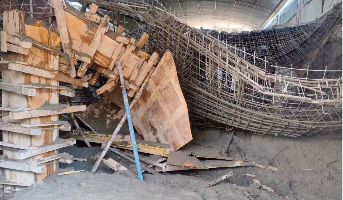
Así quedó el interior del galpón luego del derrumbe.
